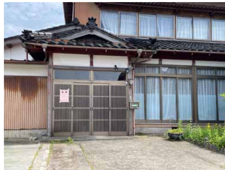
この建屋は「危険」判定
